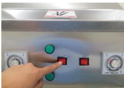
3 Encender switch de pirómetros.
